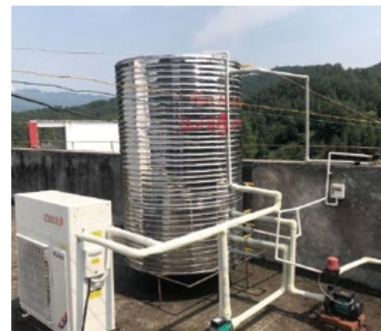
空气能热水器装置
