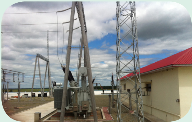
铁锋祥鹤新能源150MW平价上网风力发电项目
