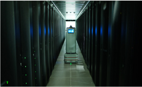
智能巡检机器人
