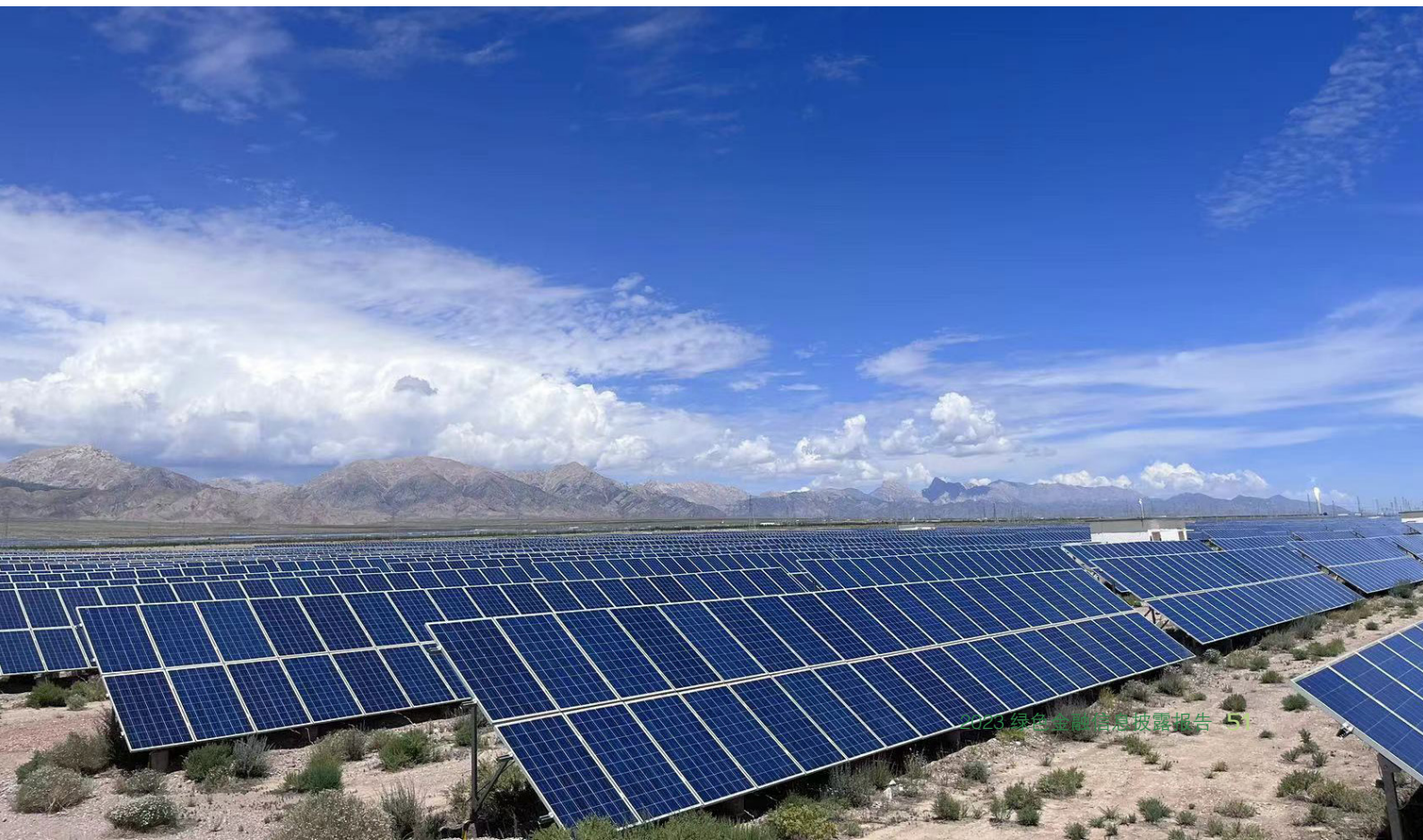
本行支持青海某光伏电站实景 ▼
